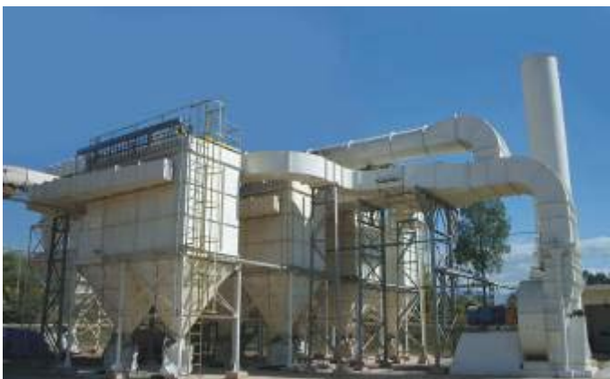
GRUPO SAINT- GOBAIN – Lorena – SP: Sistema de despoejamento fornos eletrofusão de bauxita.
