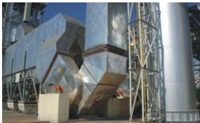
DURATEX – Botucatu – SP: Exaustores de tiragem induzida da caldeira.
