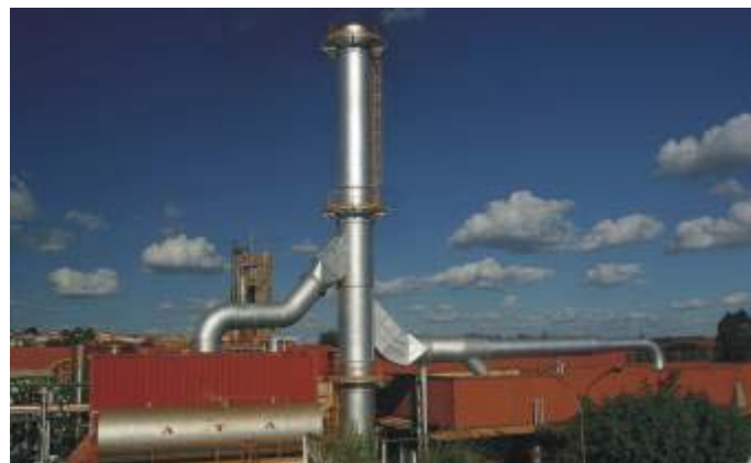
UNILEVER – Patos de Minas – SP: Sistema de exaustão das caldeiras a óleo.
