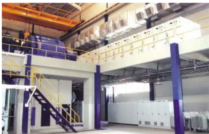
USINA CERRADINHO – Catanduva – SP: Sistema de ventilação e pressurização da casa de força.
